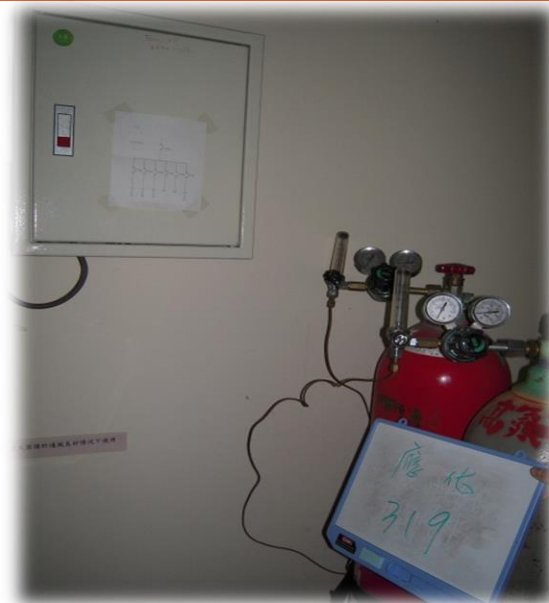
易燃性氣體且置放於配電盤下方
