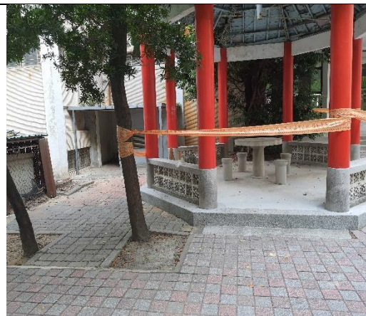
圖 2 涼亭邊牆破損
